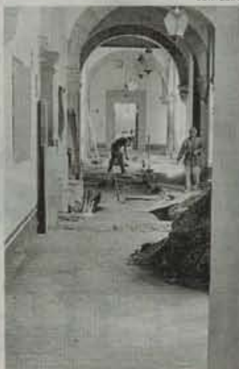
El MRG sigue en reparación
